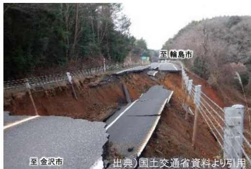
写真 能越自動車道の道路の崩壊
