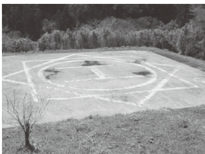
コンクリートが劣化した松原ヘリポート
