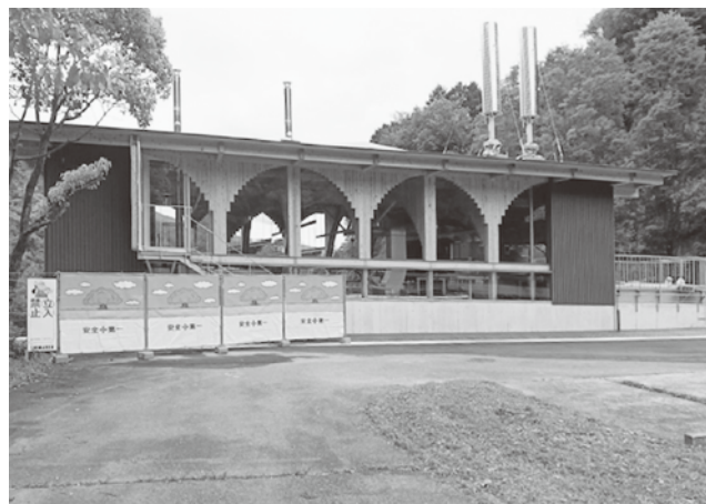
木質バイオマス発電所は現在本格稼働に向け自営線接続準備中(太郎川公園敷地内)
